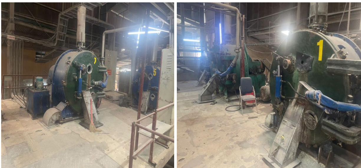
Hình 10: Công đoạn tách nước
