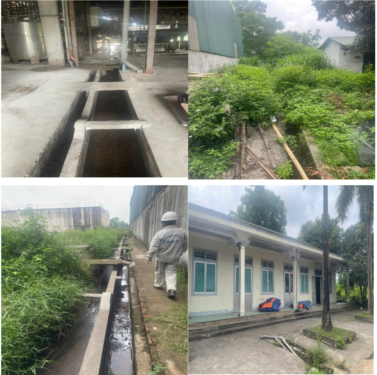
Hình 20. Hệ thống mương thoát nước và hồ ga tại Cơ sở
