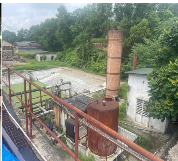
Bể UASB và bể điều hòa xử lý nước ly tâm, tách chiết tinh bột
