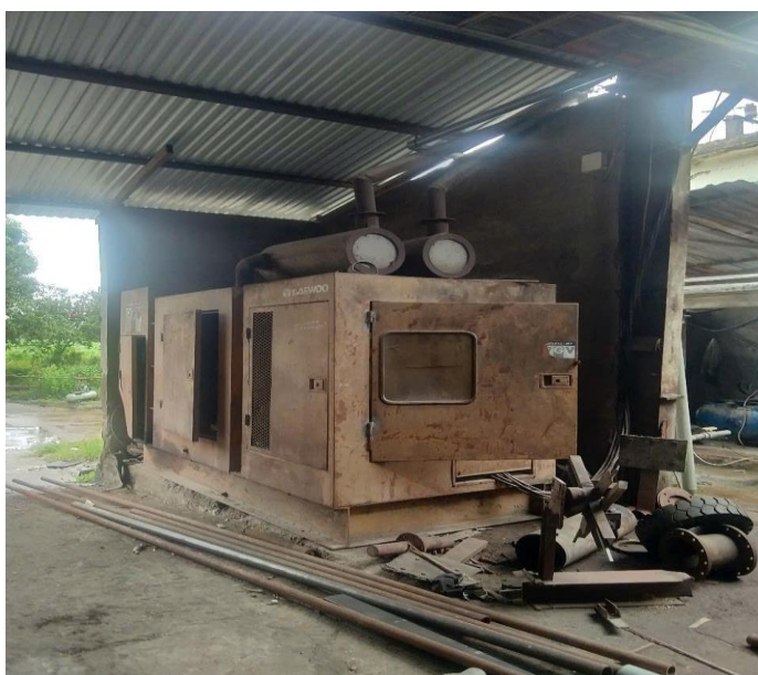
Hình 34. Khu vực đặt máy phát điện dự phòng tại Nhà máy
