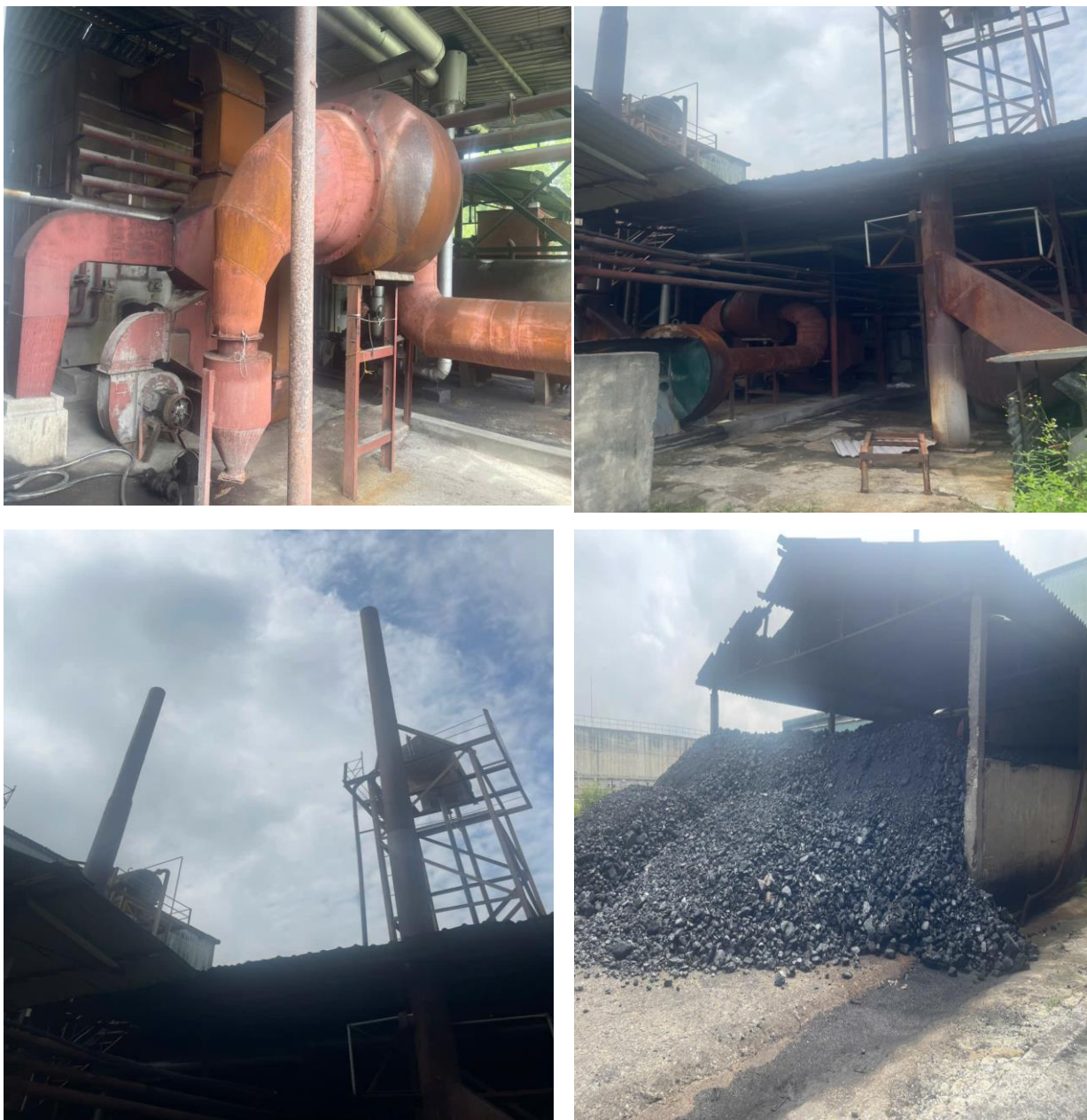
Hình 29. Một số hình ảnh về khu vực lò đốt Biogas, than và ống khói
